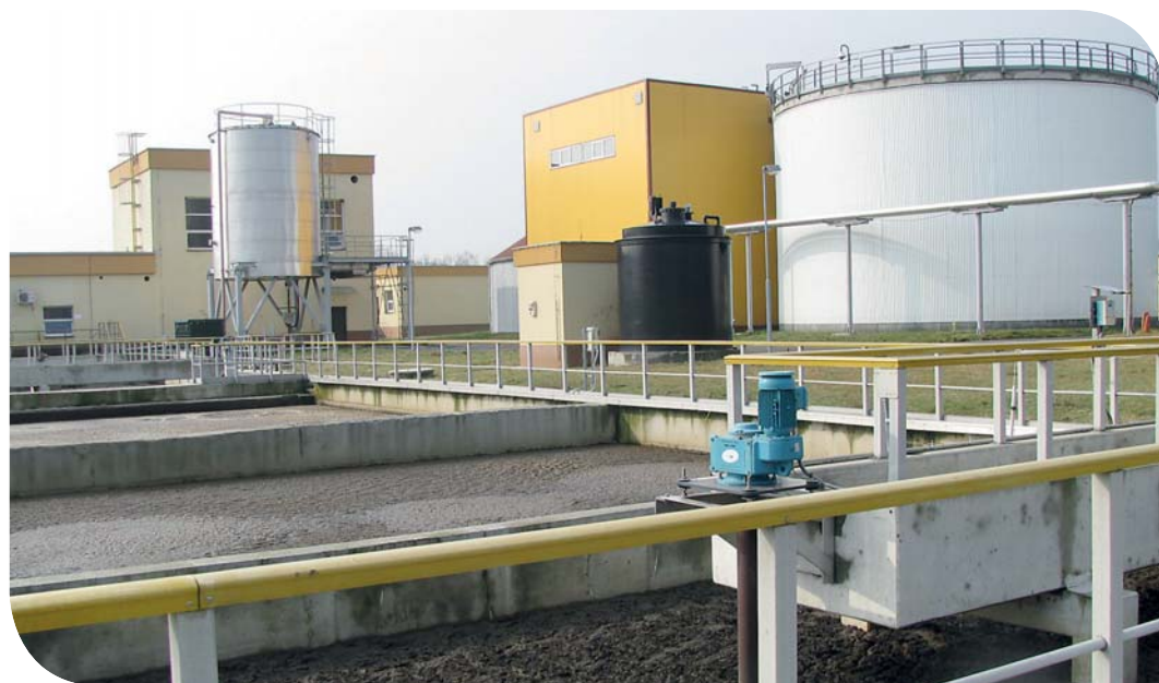
Čistírna odpadních vod Příbram
